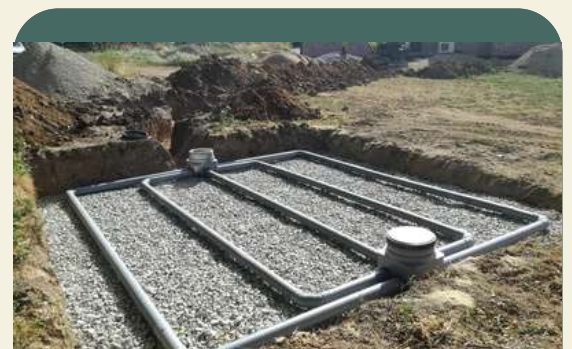
ANC : Installation d'une filière de traitement par filtre à sable vertical non drainé de 5 EH. Trémouilles 2017
